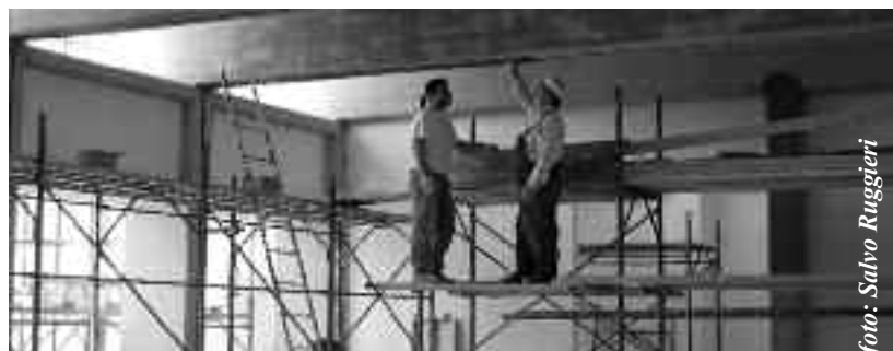
il cantiere aperto della scuola Giovanni Paolo II (Istituto Comprensivo Andrea Doria)
